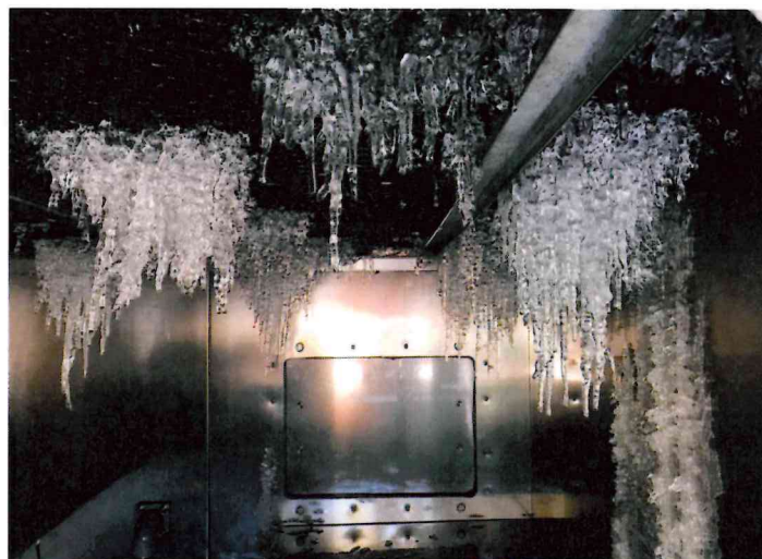
Arrêt de la TAR suite à un fort coup de gel le 11 février
